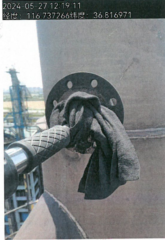
附图 1: 炭黑 4#收集袋滤器 (DA030) 处理设施后废气采样
