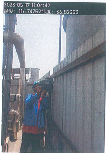
1#燃气轮机组排气筒 (DA001)
