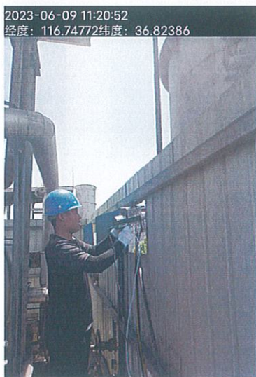
2#燃气轮机组排气筒 (DA002)
