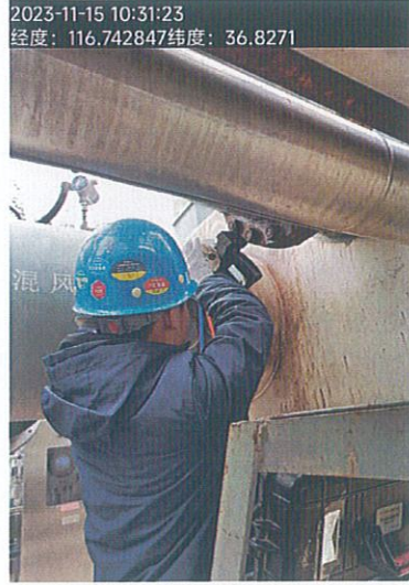
RTO 装置进口
