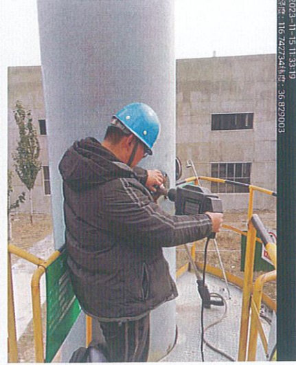
RTO 装置排气筒 (DA059)
