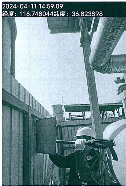
3#燃气轮机组排气筒 (DA018)
